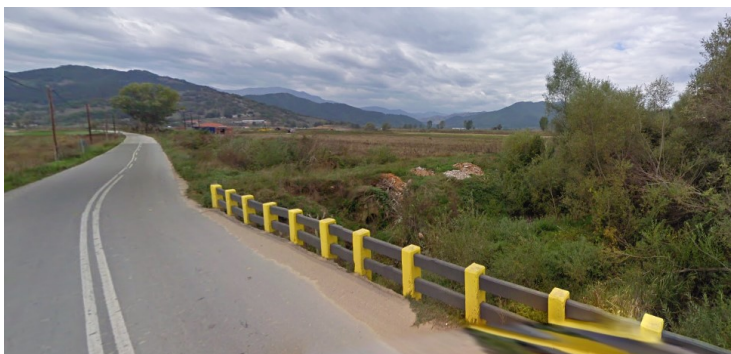
Εικόνα 4-24: Επαρχιακή οδός Σερρών-Κάτω Βροντού -Τεχνικό οχετός και πυκνή βλάστηση
