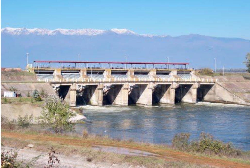
Σχήμα 3.5. Το φράγμα Λιθοτόπου στην έξοδο της Τ.Λ. Κερκίνης. Στα αριστερά (εκτός εικόνας) βρίσκεται η υδροληψία Υ2 απ' όπου τροφοδοτούνται τα αρδευτικά δίκτυα δυτικά του Στρυμόνα (Δημητρίτσι, Στρυμονικό, Νιγρίτα). Στο βάθος διακρίνεται το όρος Μπέλες.
