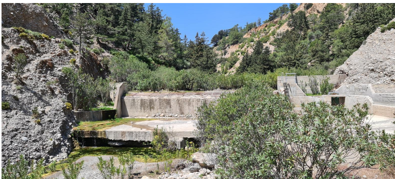
Εικόνα 4-6 Έργο υδροληψίας επί του ποτάμιου ΥΣ EL1438R002100070H (Κολωνίτης ή Σκολωνίτης)
