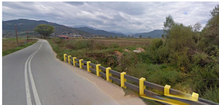
Εικόνα 4-19: Επαρχιακή οδός Σερρών-Κάτω Βροντού -Τεχνικό οχετός και πυκνή βλάστηση Για την ποσοτική αξιολόγηση των υδρομορφολογικών αλλοιώσεων που συντελούνται λόγω των ως άνω έργων αποστράγγισης και διευθέτησης, εφαρμόζονται τα αντίστοιχα κριτήρια και συγκεκριμένα αυτά που έχουν εφαρμοσιμότητα στις συγκεκριμένες τροποποιήσεις (Α.4.1, Α.4.2). Οι τιμές των κριτηρίων φαίνονται στον παρακάτω Πίνακα.
