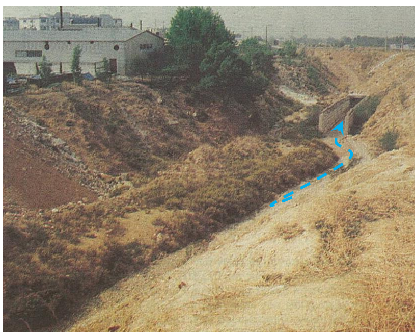
Σχήμα 2-10 Είσοδος Οχετού Πύρνας ανάντη Εθνικής Οδού - όψη προς τα κατάντη (Πηγή: ΕΥΔΑΠ)
